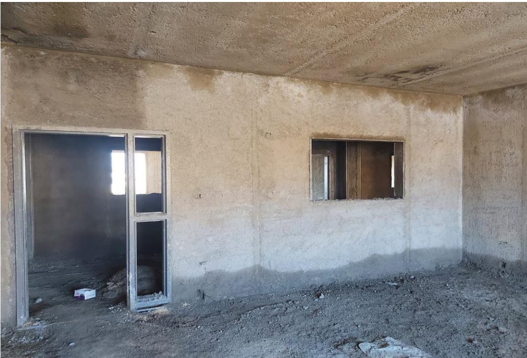
Unwrapped steel door frame
